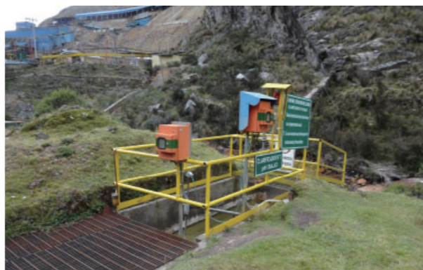
24時間体制での水質モニタリング。全排水口で実施しています
